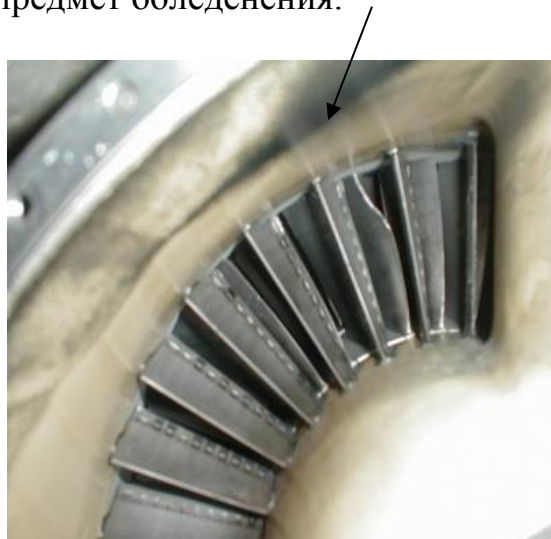
Рисунок 5 – Повреждения лопаток I ступени входного направляющего аппарата и рабочего колеса компрессора
